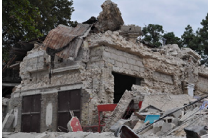
Şəkil 4: Möhkəmləndirilməmiş tikinti binası dağılıb
