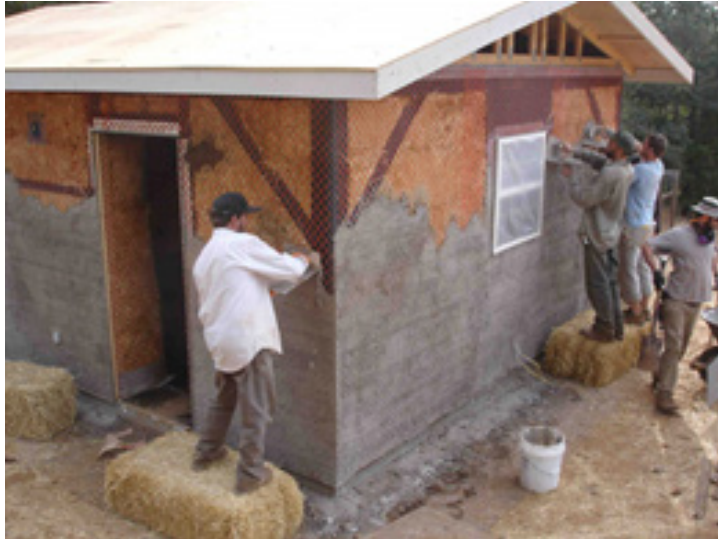
Şəkil 4: Tor ilə tətbiq edilən əhəng əsaslı suvaq
